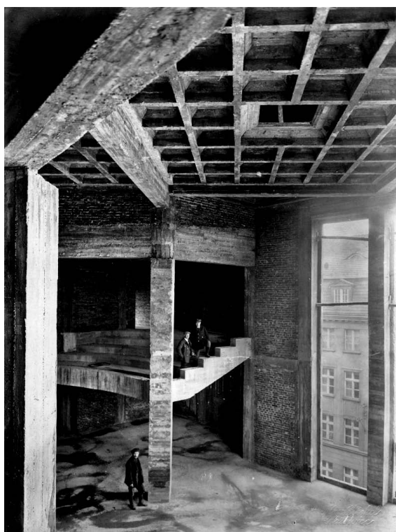
Dom Oświatowy Towarzystwa Czytelni Ludowych w Katowicach w trakcie budowy – sala odczytowa, 1930–1934
